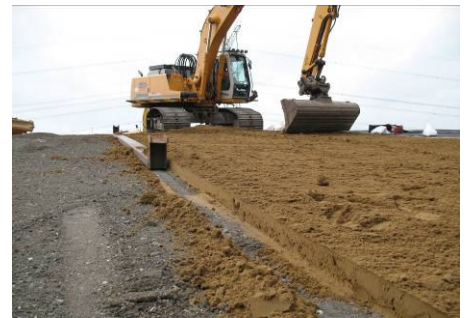
Middels een afreibalk wordt de onverdichte Trisoplast in de juiste laagdikte aangebracht
